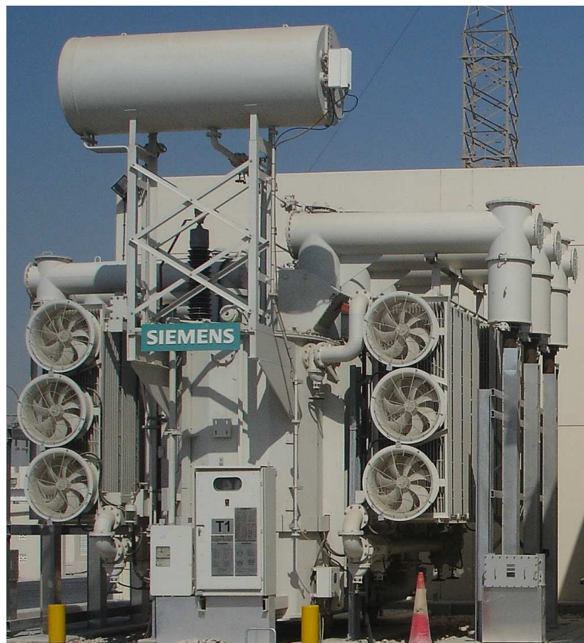
Figura 30. Transformador de potencia.
