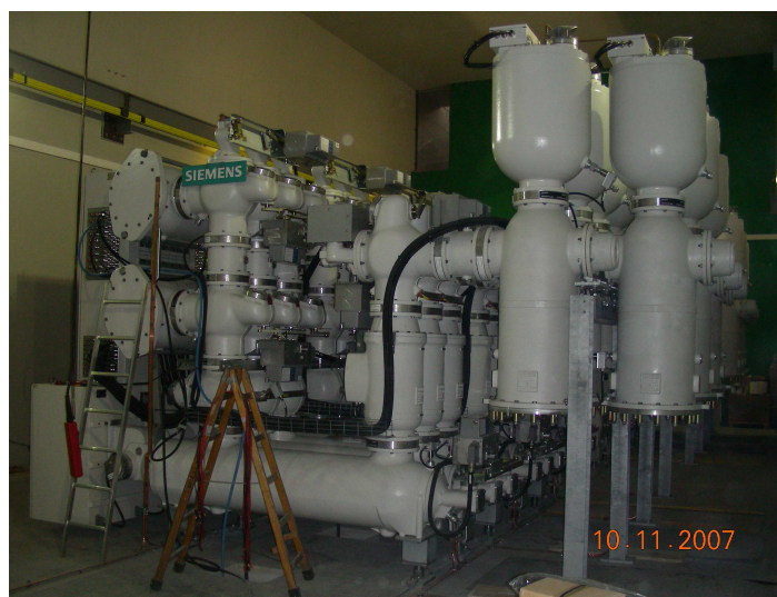
Figura 6. Subestación GIS La Cereal 220kV, vista lateral.
