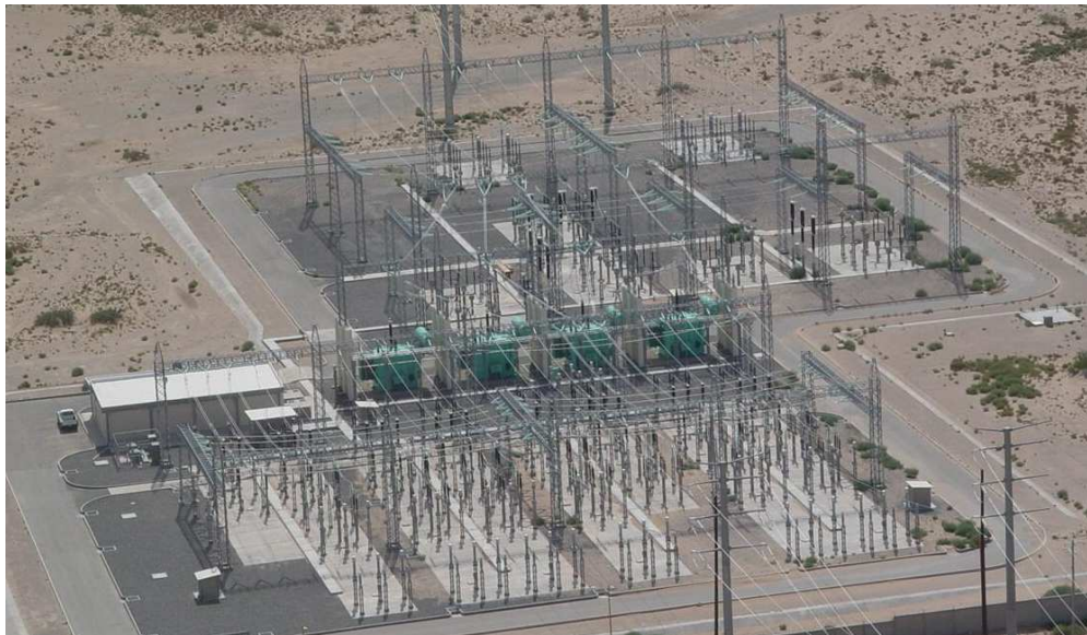
Figura 3. Subestación de intemperie.
