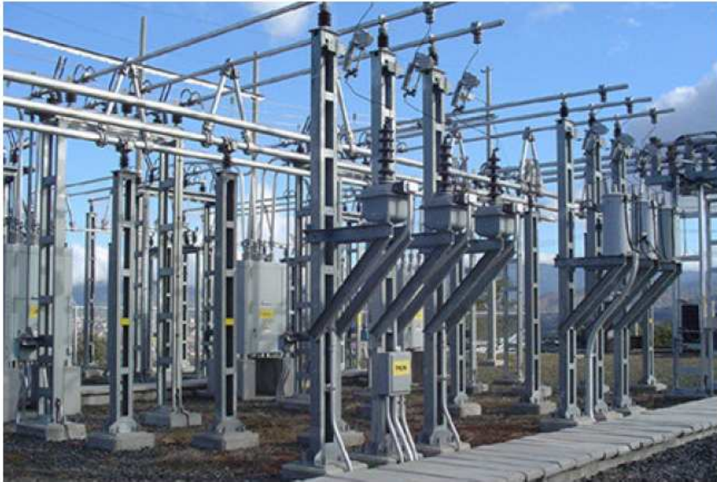
Figura 5. Ejemplo de embarrado de una subestación eléctrica.
