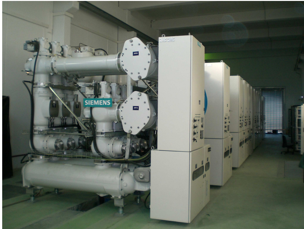
Figura 4. Subestación GIS e interior.
